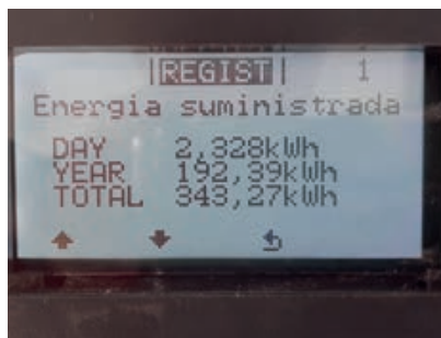
Control de suministro energético en punto de carga para vehículos eléctricos asociados a instalación fotovoltaica
