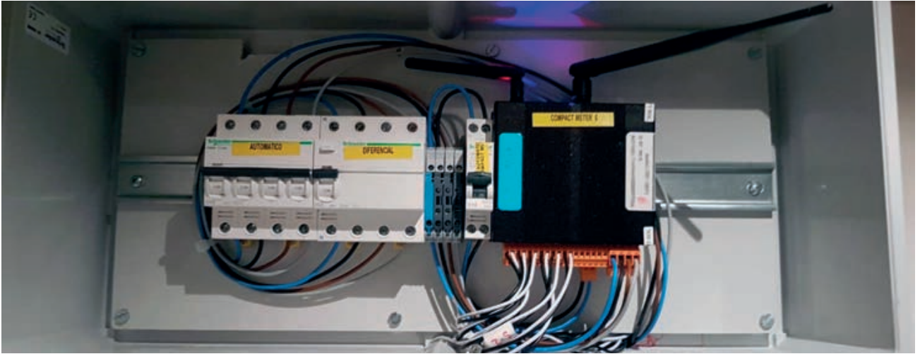
Registrador de datos en centro de transformación
